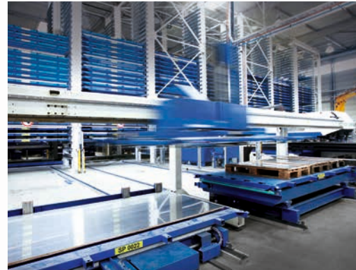
Be- und Entladestation zur Anbindung an eine Stanz-Laser-Kombimaschine.
